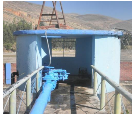
Interior de Caseta de Válvulas
