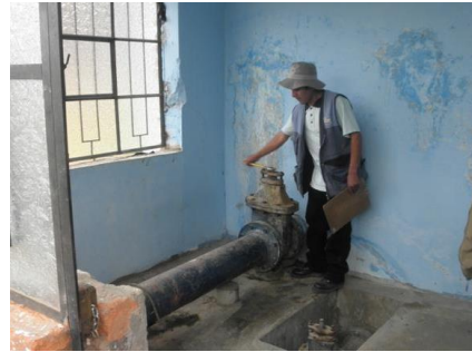
Interior de Caseta de Válvulas
