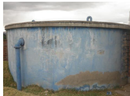
Cisterna de 150 m 3 de Capacidad
