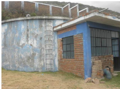
Reservorio Apoyado 350 m 3 - ORCOTUNA
