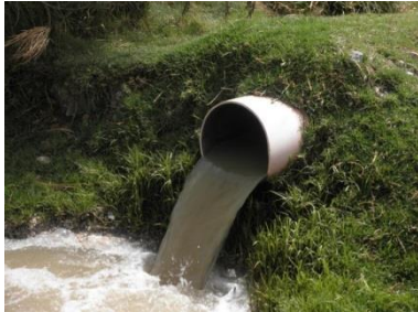
Descarga de desagüe Fundo Porvenir El Tambo
