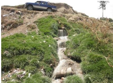
Descarga de Desagüe Av. Leoncio Prado
