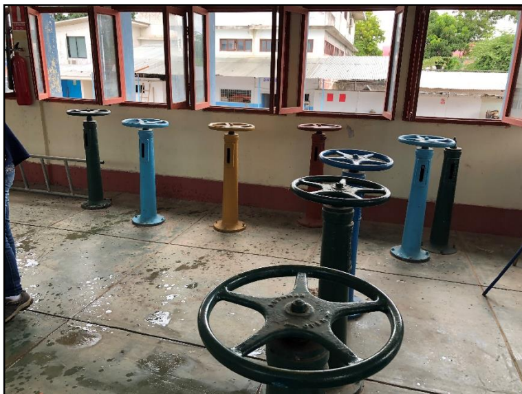
Imagen N° 7: Sala de operación de válvulas
