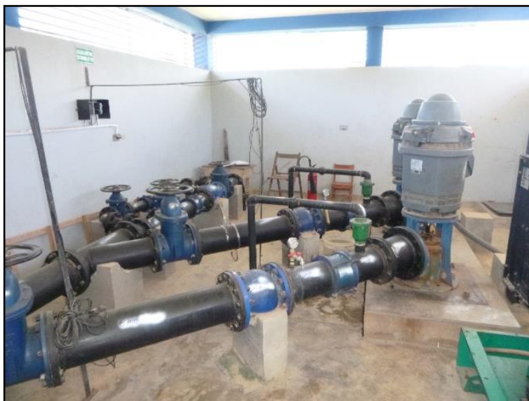
Imagen N° 24: Estación de Bombeo Las Colinas
