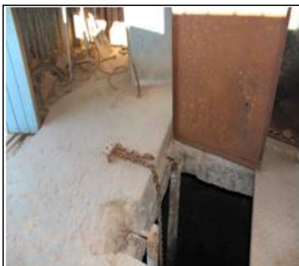
Imagen N° 31: Cámara de Bombeo de Desagüe D-14
