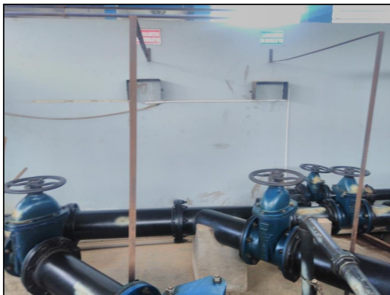
Imagen N° 23: Estación de Bombeo Cesar Vallejo
