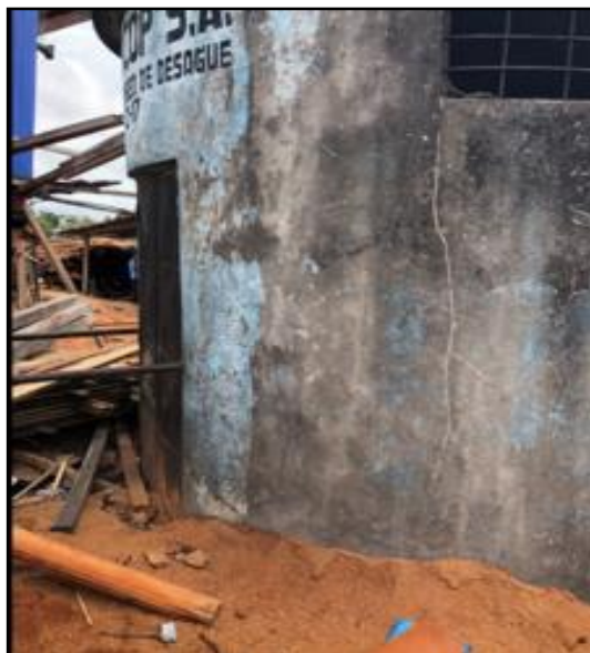
Imagen N° 26: Cámara de Bombeo de Desagüe D-17
