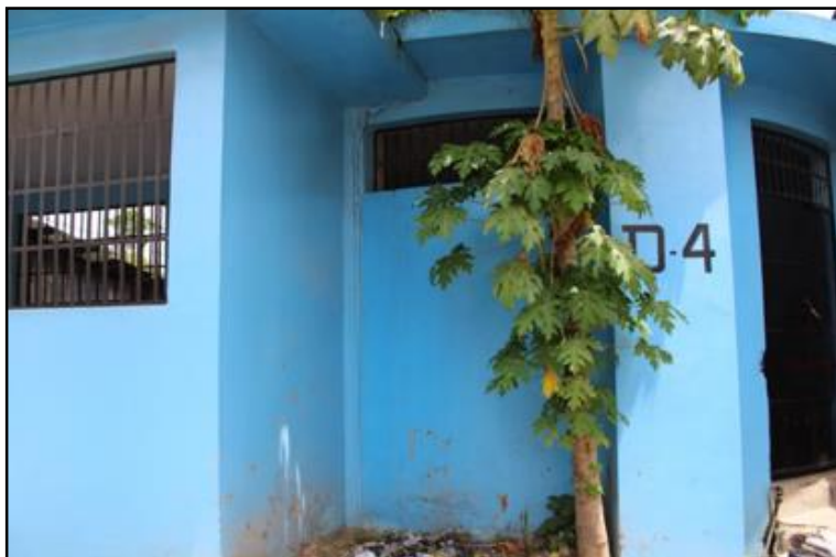
Imagen N° 30: Cámara de Bombeo de Desagüe D-4
