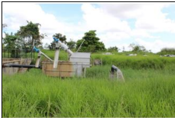
Imagen N° 44: PTAR N° 02 Lodos Activados
