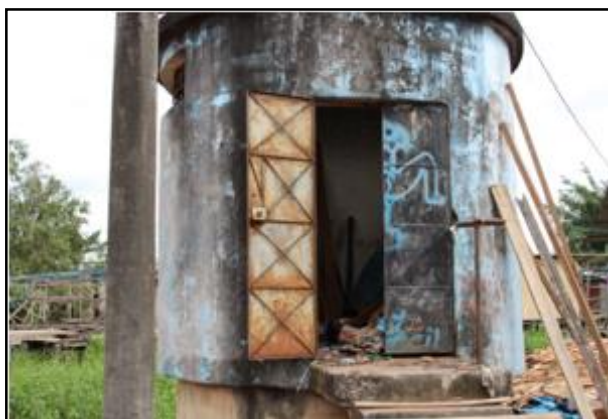
Imagen N° 27: Cámara de Bombeo de Desagüe D-15
