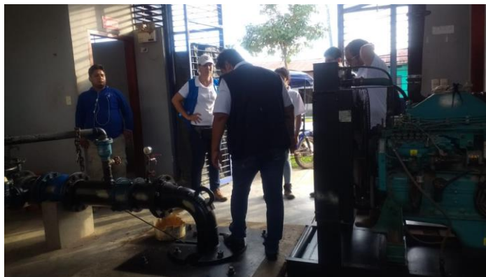
Imagen N° 52: Captación de fuente subterránea a través de pozos tubulares
