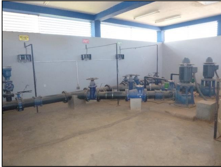
Imagen N° 22: Estación de Bombeo Padre Salas
