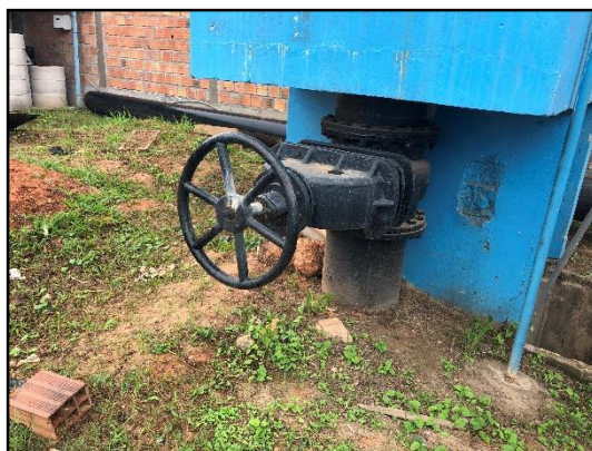
Imagen N° 5: Mezcla rápida de la PTAP
