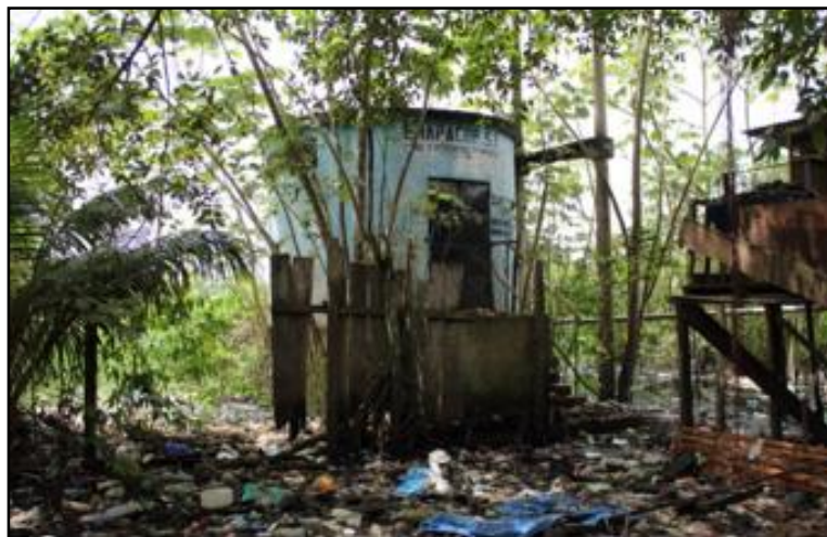
Imagen N° 25: Cámara de Bombeo de Desagüe D-12
