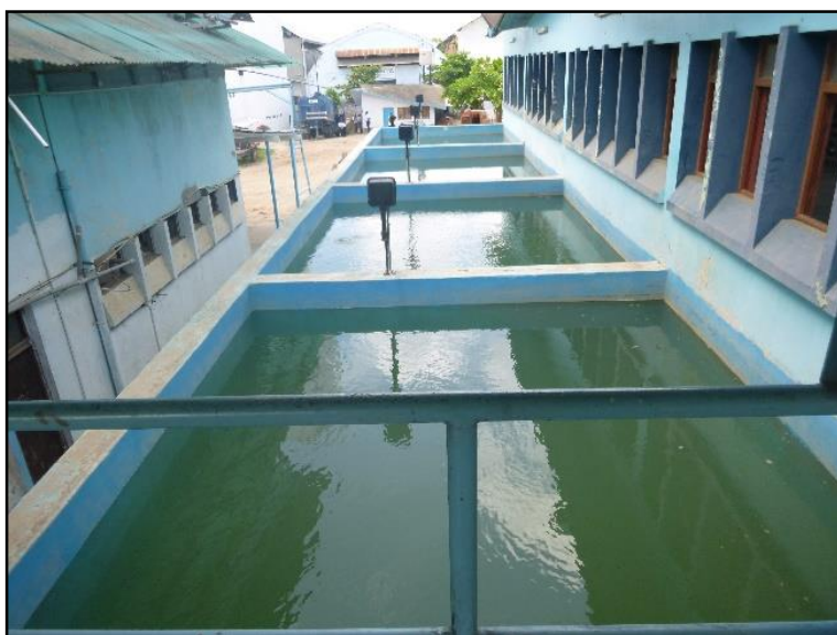
Imagen N° 8: Batería de Filtros
