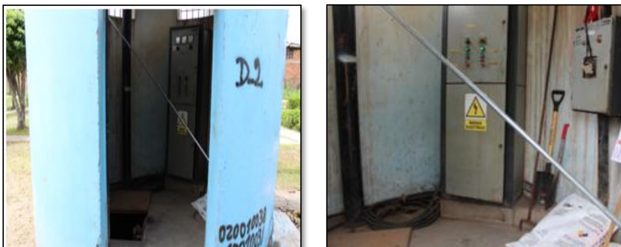
Imagen N° 29: Cámara de Bombeo de Desagüe D-2
