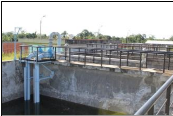
Imagen N° 47: PTAR N° 04 Lodos Activados
